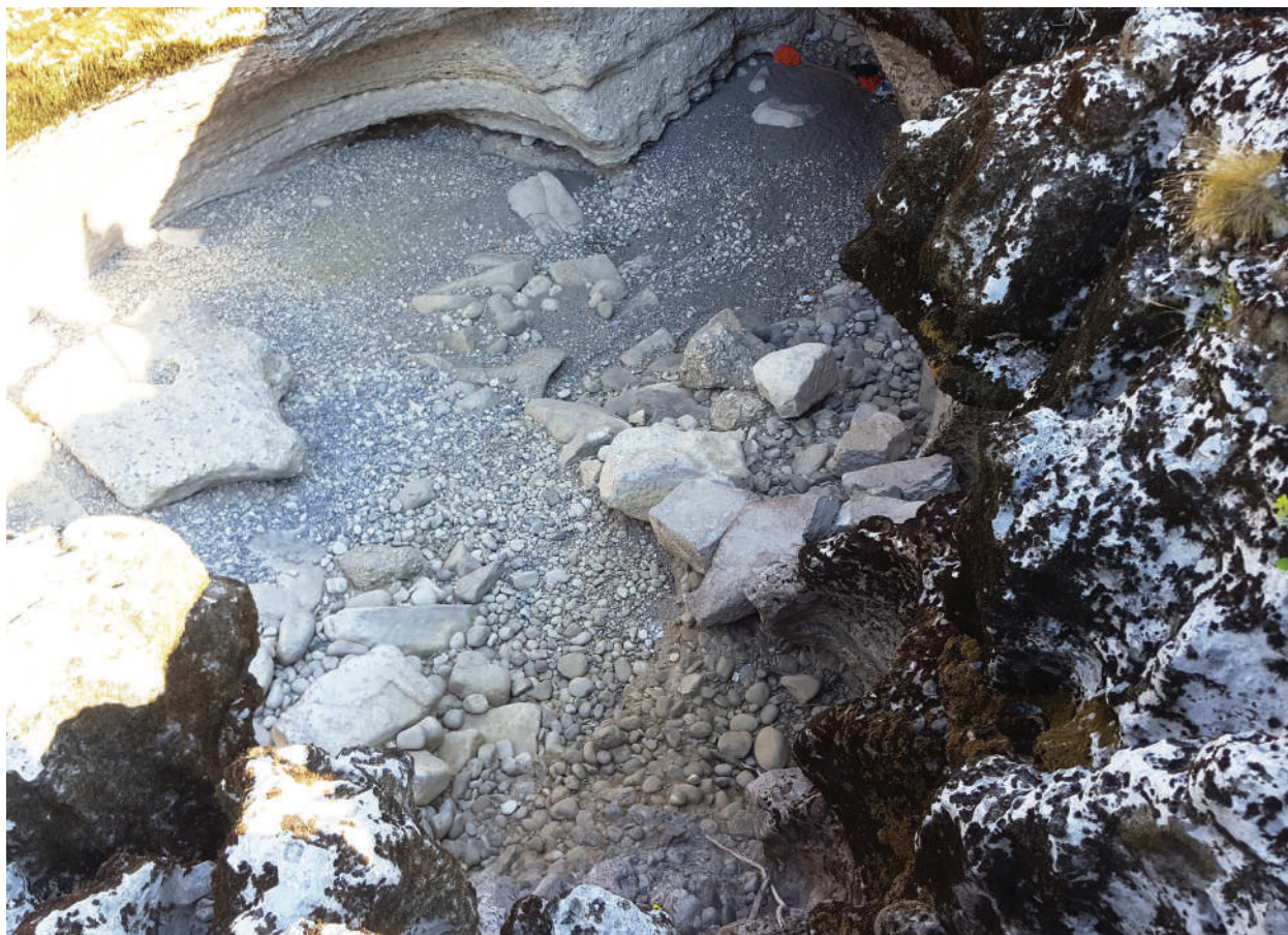
Sl. 18. Srušeni most na dnu Cijevne
